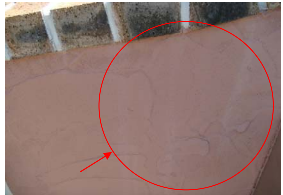
笠木目地付近から垂れている
